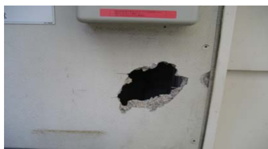
石綿含有石膏ボード
